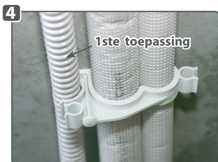
Condens slang (het water loopt weg door de zwaartekracht)
