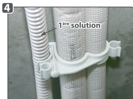
Tuyau de condensat (l'eau s'en va par gravité)
